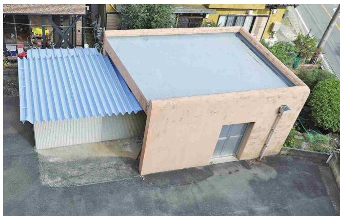
▲敷地内にある旧豊川電話中継所倉庫(現在は東半分のみ現存)
